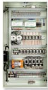
電控箱裝置 Electrical Cabinet
